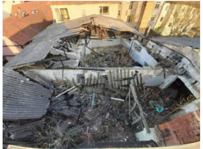
Bild 1: Ausmaß der Schäden am Anbau in der Hirtenstraße
